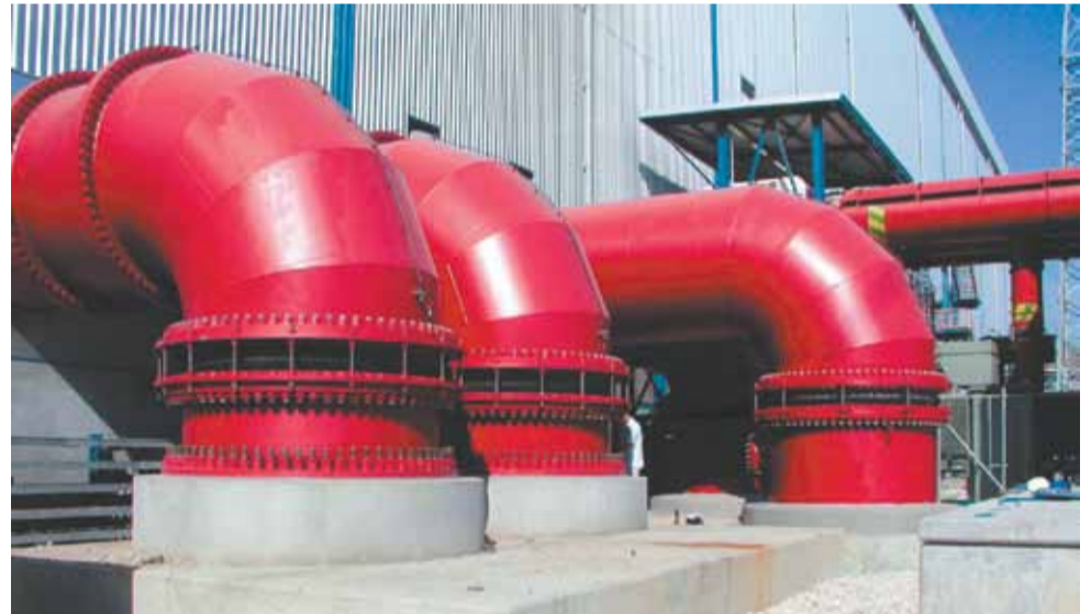
Резинокордные компенсаторы на трубопроводе
